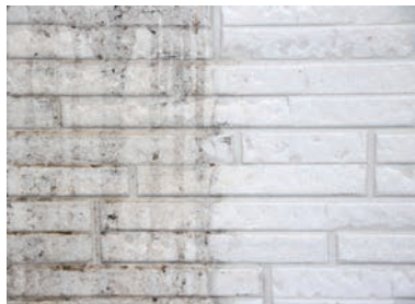
未塗布 EN塗布
